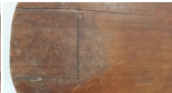
Figura 52 Detalle de parche de madera y fisura generada
