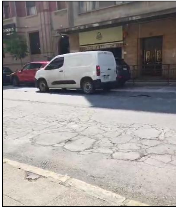
Figura 10: Amunátegui deteriorada y vehículo DUM estacionado en doble vía.
