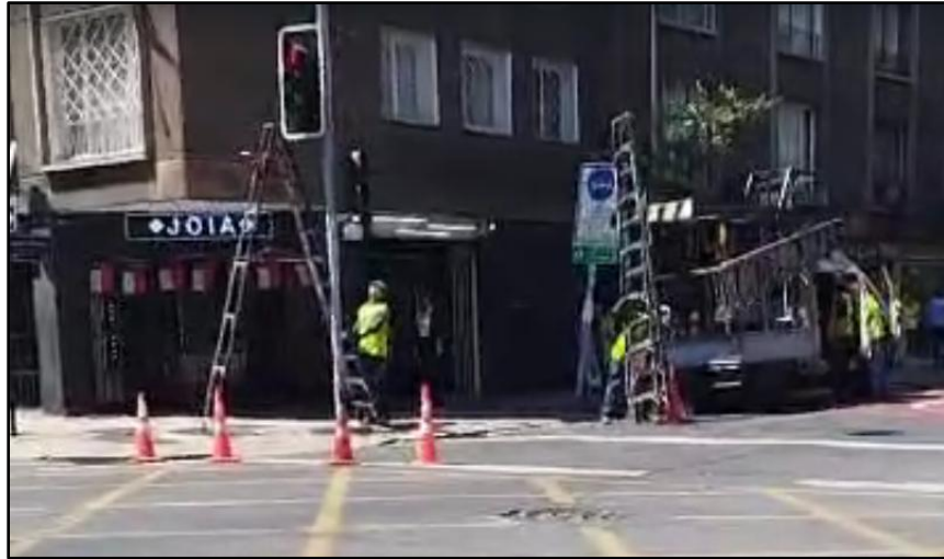
Figura 16: Reparaciones obstruyendo el paso peatonal.
