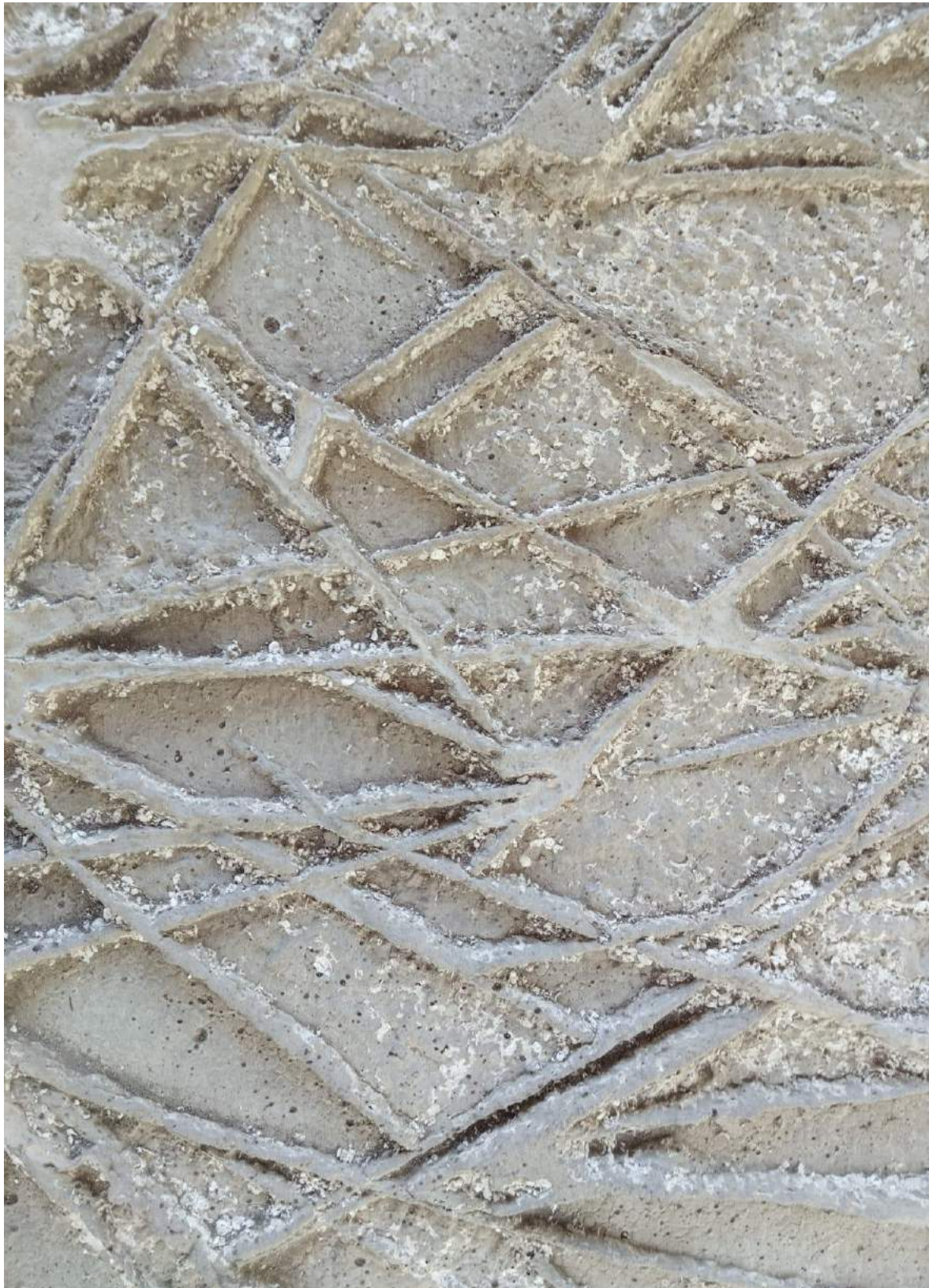
Figura 20: Registro fotográfico de detalle de plancha de hormigón intervenida. 2023. Autoría propia.
