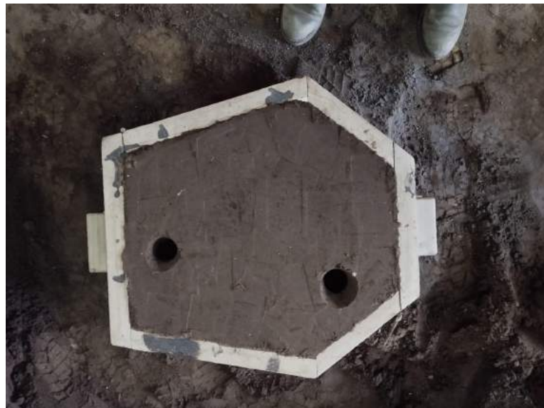
Figura 28: Registro fotográfico de orificios de vaciado y respiración. 2023. Autoría propia.
