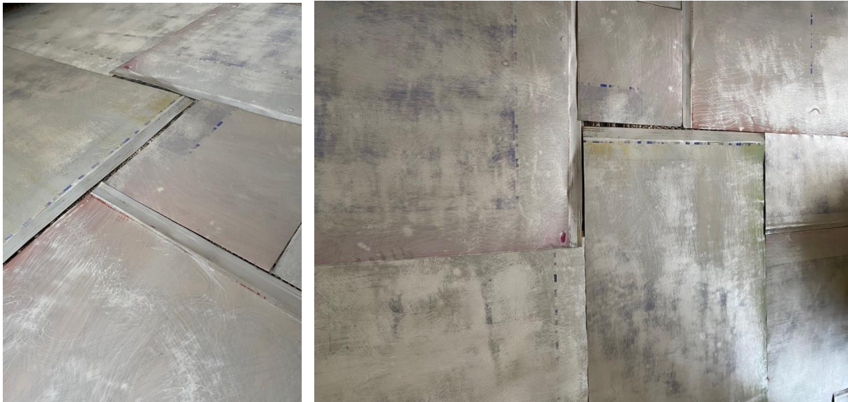
Fig. 3 _Planchas de zinc desgastadas
