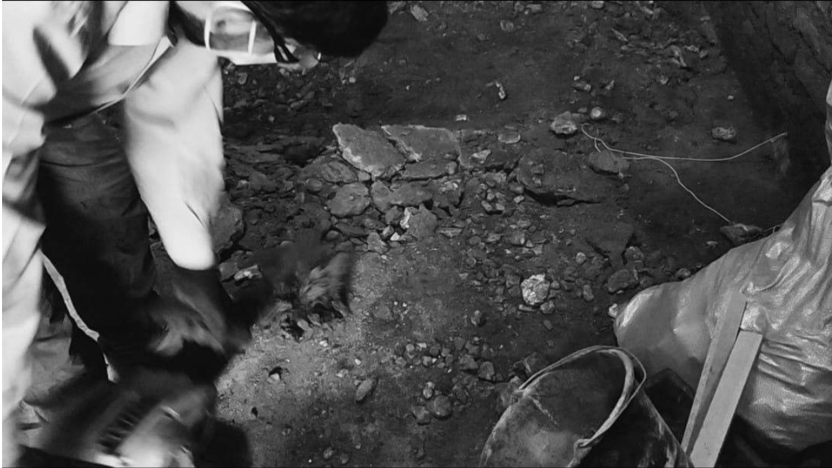
Figura 4: Destrucción del piso al realizar un radier, 2023. Archivo personal
