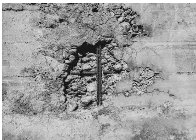
Figura 7: muro de hormigón en la vía pública y su armado de estriado visible, 2023. Archivo personal
