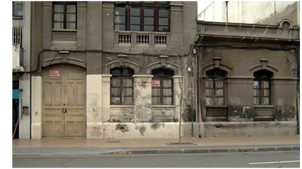
CASAS EN DETERIORO
