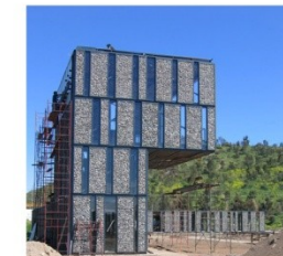
parque metropolitano Cerro Chena Santiago, Chile. arquitectos: Antonio Polidura y Pablo Talhouk
