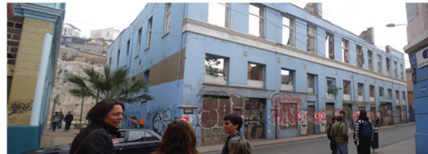
FACHADAS REFORZADAS Y SIN USOS, O CON PELIGRO DE DERRUMBE.
